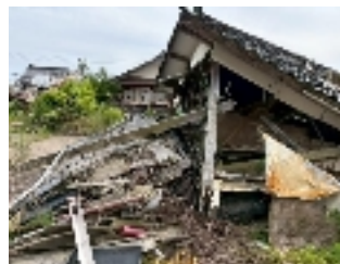
珠洲市も倒壊家屋がそのまま
